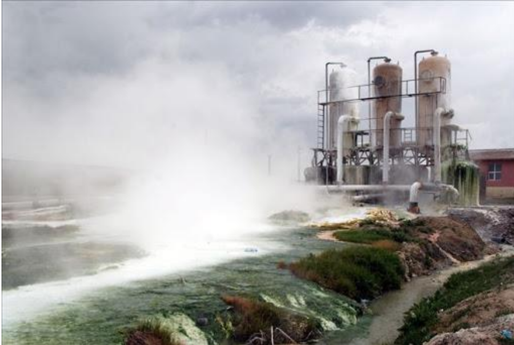
Şekil 1: Jeotermal sıcak su kaynakları ile ilgili bölgeden genel fotoğraflar (Diyadin ilçesi bölgesel şehir ısıtması tesisi).
